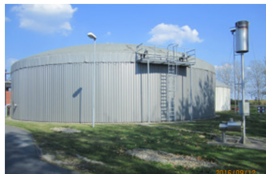
バイオ燃料を発酵させる大きなタンク。
